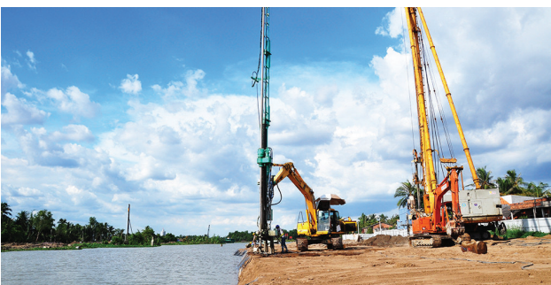
Dự án Âu Tàu Rạch Chanh Ứng dụng: gia cố nền bằng cọc xi măng đất
